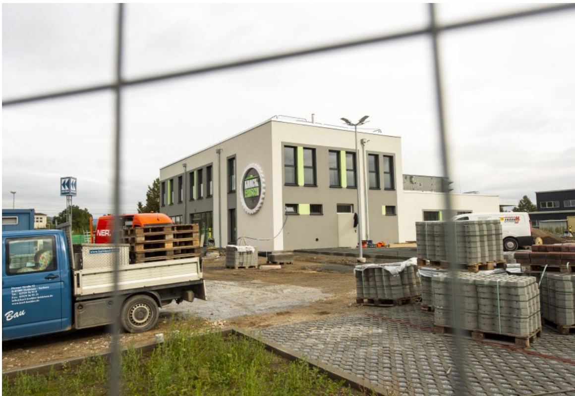
„Knack Frisch“-Baustelle im Gewerbegebiet „An der Elbe“: Im November soll ein zweimonatiger Probetrieb beginnen. Foto: Norbert Millauer
